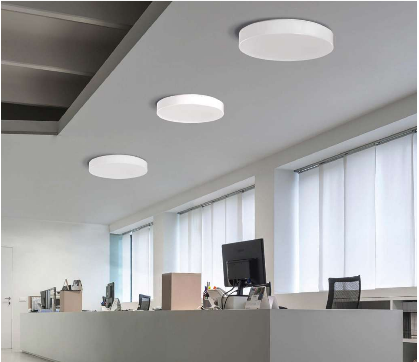
Ceiling lamps / Iluminación de techo
